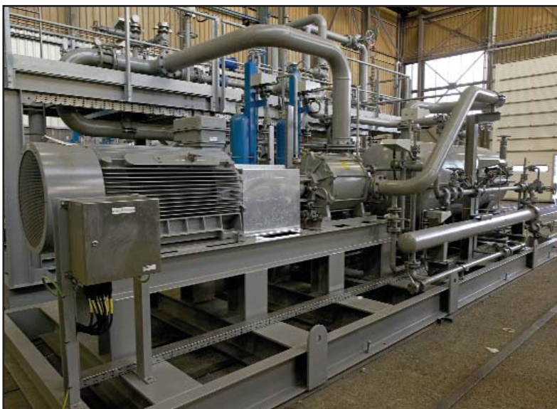
Impianto di compressori per gas di processo Vectra XL350
