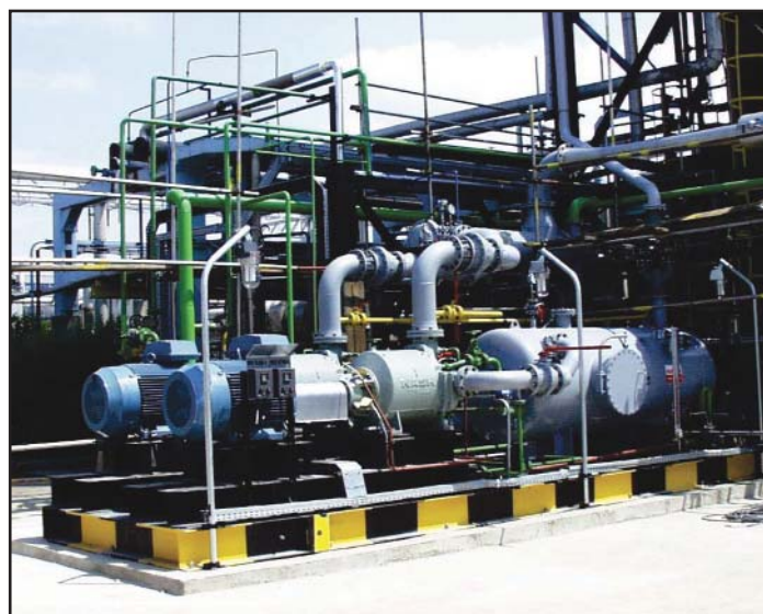
Sistema per vuoto Duplex in una colonna di distillazione del greggio
